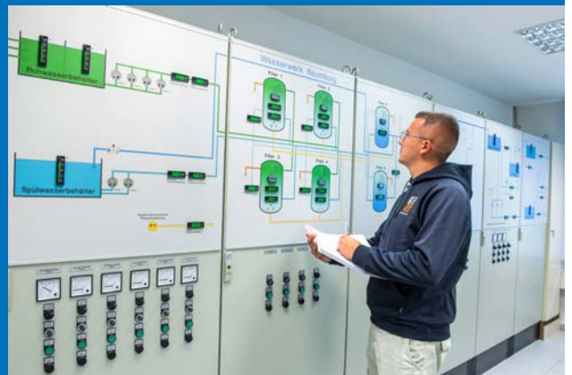
Felix Bornschein kontrolliert die Messwerte des aufbereiteten Wassers (Bild oben). Im Wasserwerk Naumburg reinigen vier Mehrschichtfilter und zwei Aktivkohlefilter das Rohwasser aus der Saale (Bild links).
